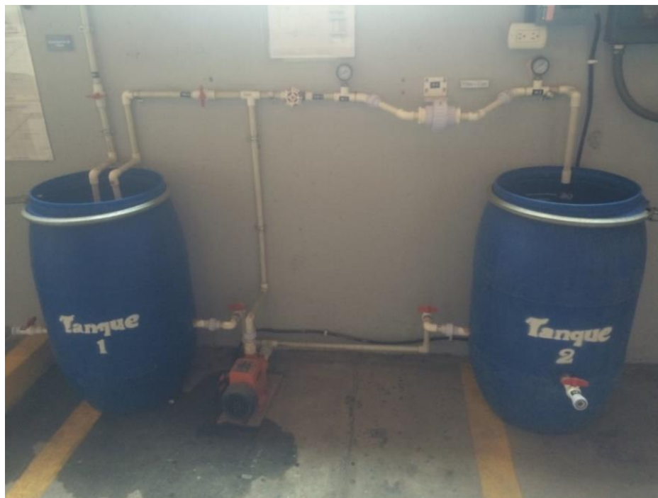
Figura 30. Módulo instalado en la estación experimental
