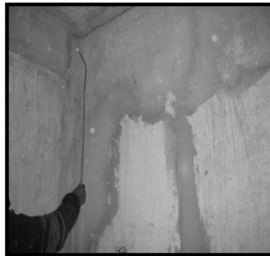
Figura 34. Revisión correcta de resanes con varilla de hierro
