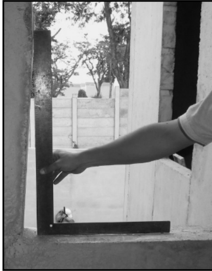
Figura 12. Producto no conforme, ventana en obra gris desalineada
