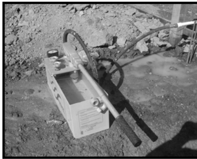
Figura 23. Bomba instalada en tubería
