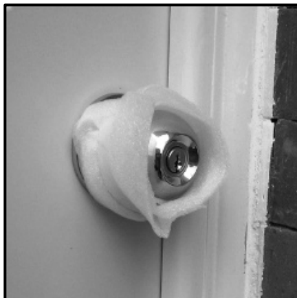
Figura 38. Perilla protegida con yumbolón evitando oxidación
