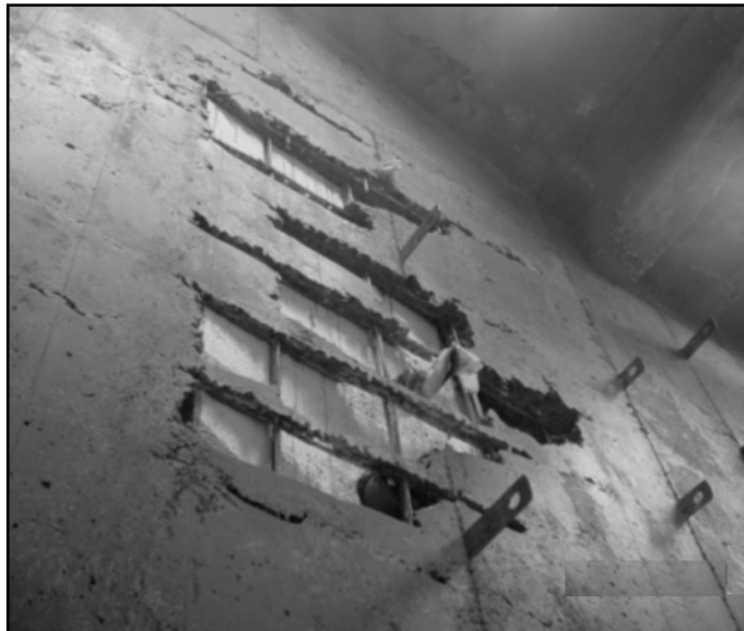
Figura 11. Pared agrietada por mala aplicación de concreto
