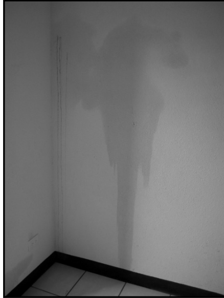
Figura 8. Fuga de agua en tubería, observada en la pared texturizada
