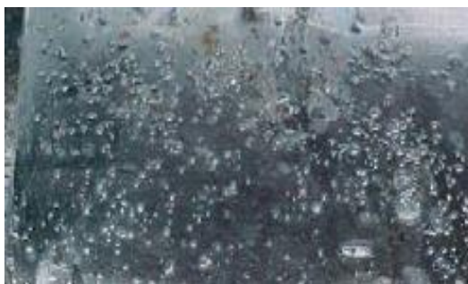
Figura 7. Aspecto de material galvanizado con grumos
