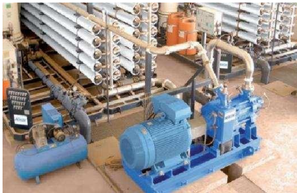
Figura 14. Sistema Desalator de Veolia Water
