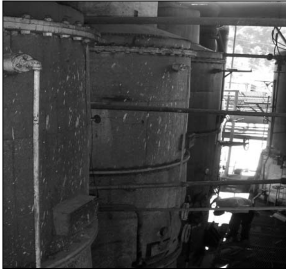
Figura 8. Evaporadores de múltiple efecto
