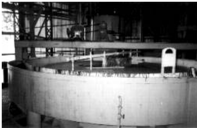
Figura 21. Clarificador de meladura.
