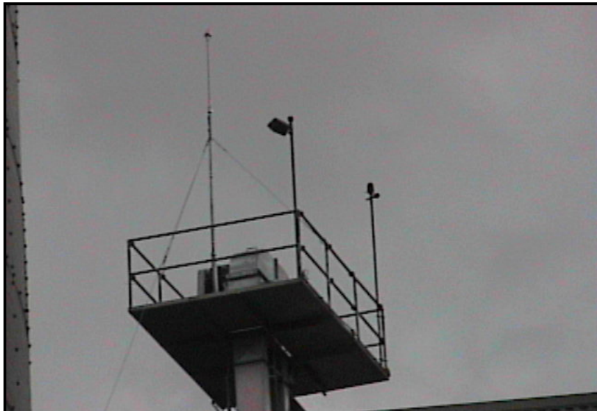
Figura 21. Instalación pararrayos Saint Elme 15
