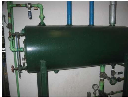
Tanque de suministro de agua a caldera
