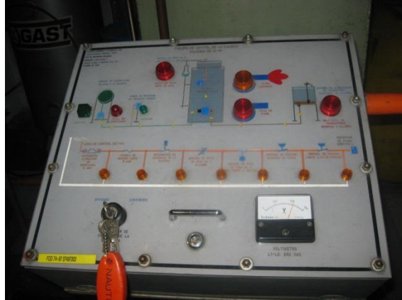
Panel de control y arranque
