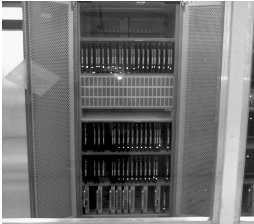
Figura 1. Bastidor marca Alcatel con capacidad para 768 servicios
