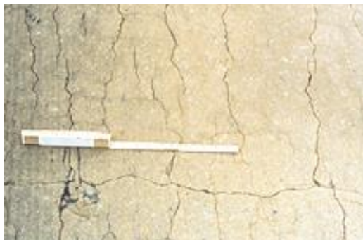
Figura 12. Concreto fisurado debido a la reactividad potencial álcali-sílice (fondo)
