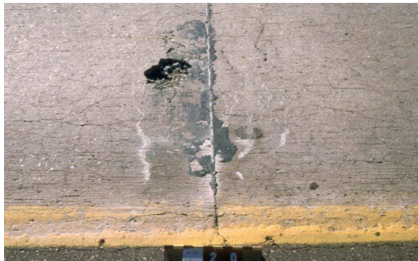
Figura 17. Reacción perjudicial álcali-sílice en pavimento de Nebraska
