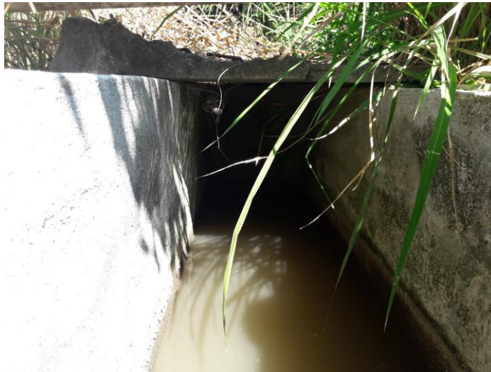
Figura 2. Pozo de excedencias
