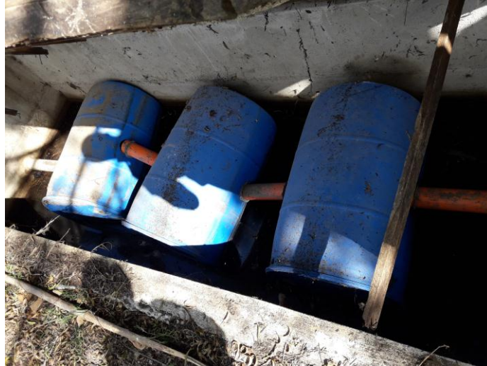
Figura 8. Filtro de carbón activado
