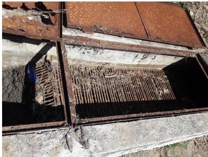
Figura 3. Canal de rejas
