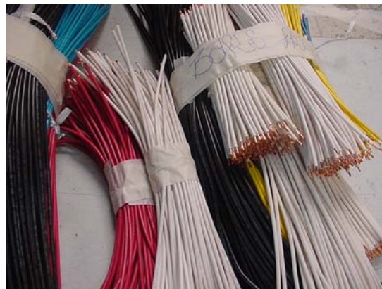
Figura 24. Ineficiencia en identificación de cables
