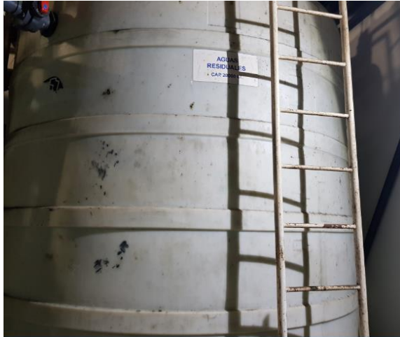
Figura 30. Tanque de homogenización de caudal.
