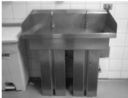
Figura 15. Estación de lavado de manos
