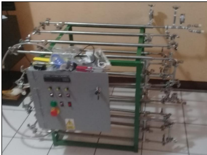
Figura 7. Reactor con tablero eléctrico instalado
