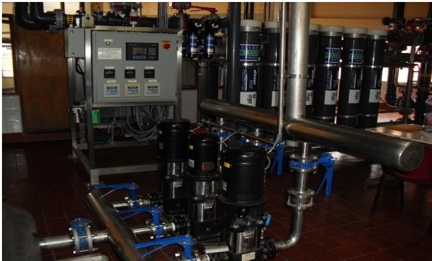
Fuente: Planta de Ultrafiltración.
