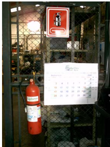
Figura 28. Señal de extinguidor
