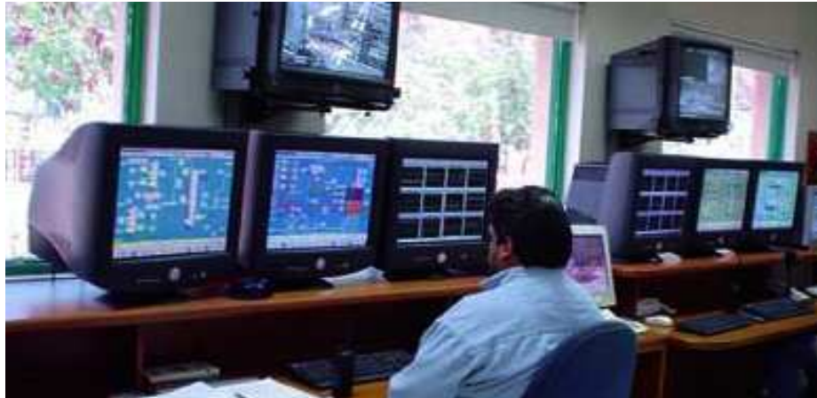
Figura 12. Cuarto de control de la planta de producción de crudo, controlada por el sistema SCADA.
