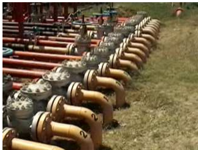
Figura 10. Fotografía del Manifold de entrada al campo Xan.
