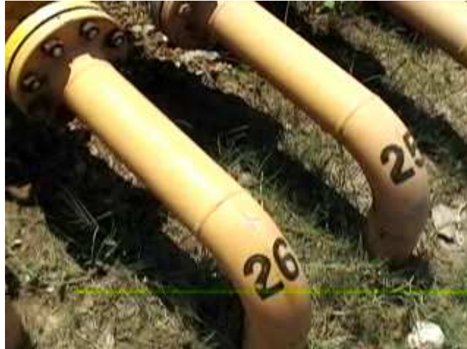
Figura 11. Numeración de las tuberías provenientes de los pozos de extracción de crudo en el manifold de entrada.
