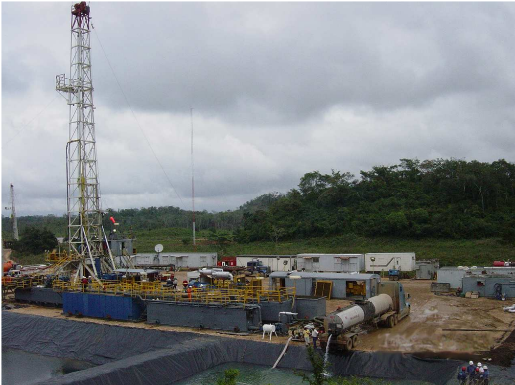
Figura 9. Torre construida durante la excavación del pozo numero 10 en el campamento Xan, Petén, Guatemala.
