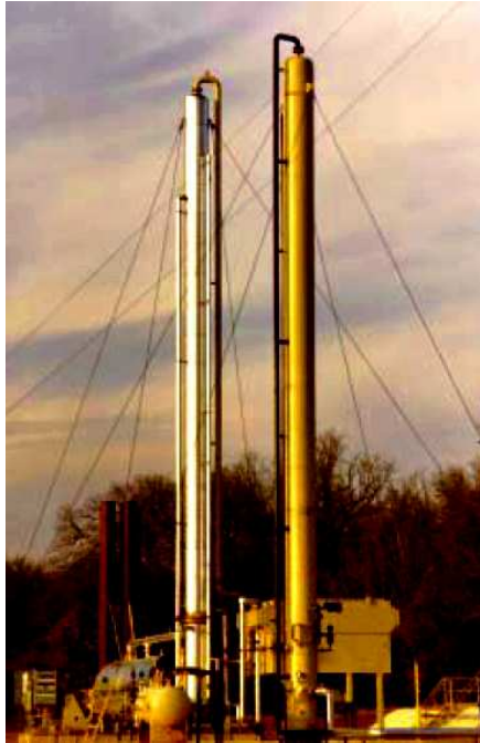
Figura 15. Torre contactora y torre de regeneración de amina.
