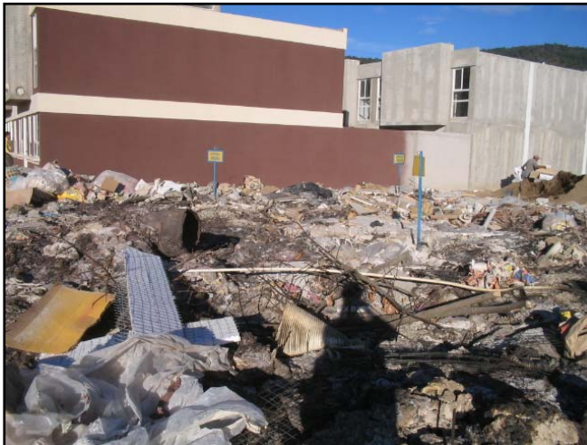
Figura 101. Situación actual de los desechos de hierro.
