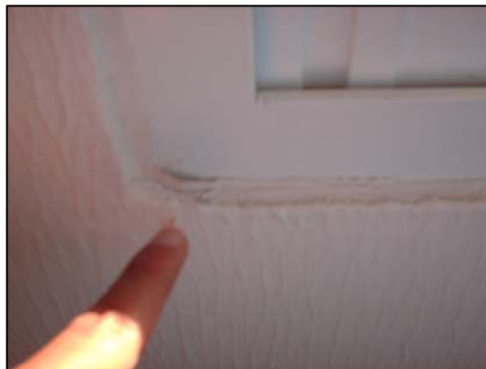
Figura 25. Mala aplicación del sello de ventanas
