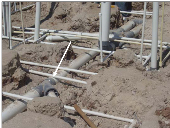
Figura 12. Excavación incorrecta para la tubería de agua potable
