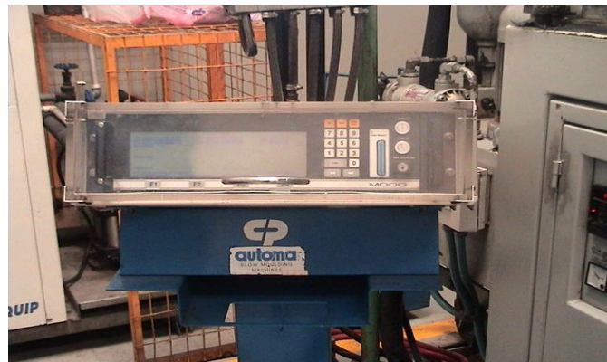
Figura 23. Tablero del control parisson
