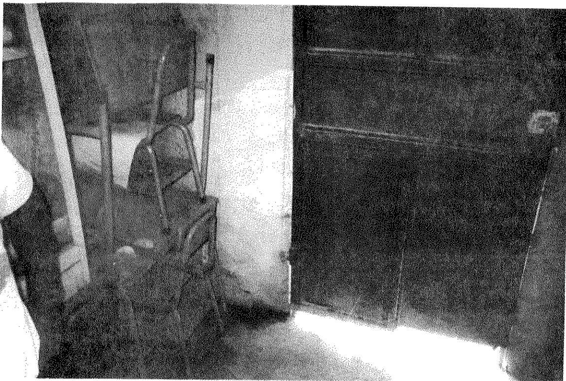
En el interior de una aula se observan los daños ocasionados por la colocación de las puertas y la caída de el repello
