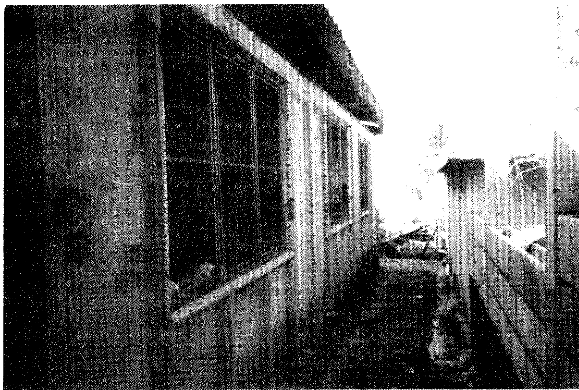
Vista Posterior de la escuela rural de Santa Cruz Quixaya, en donde se observan los cimientos y las juntas panel-panel
