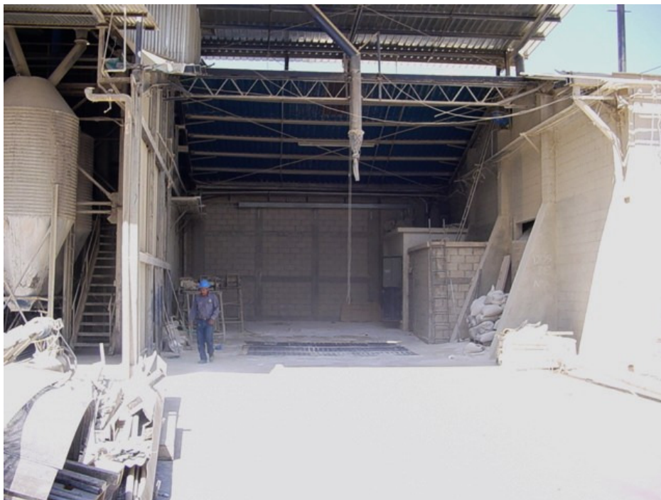
Figura 78: Estado de la tolva de descarga antes del proyecto.
