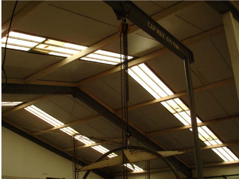
Figura 38. Techo y polipasto de área de frascos
