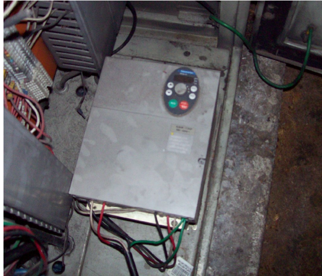
Figura 2. Variador de frecuencia
