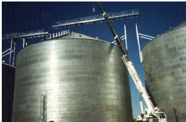
Figura 5. Silos de almacenamiento del maíz
