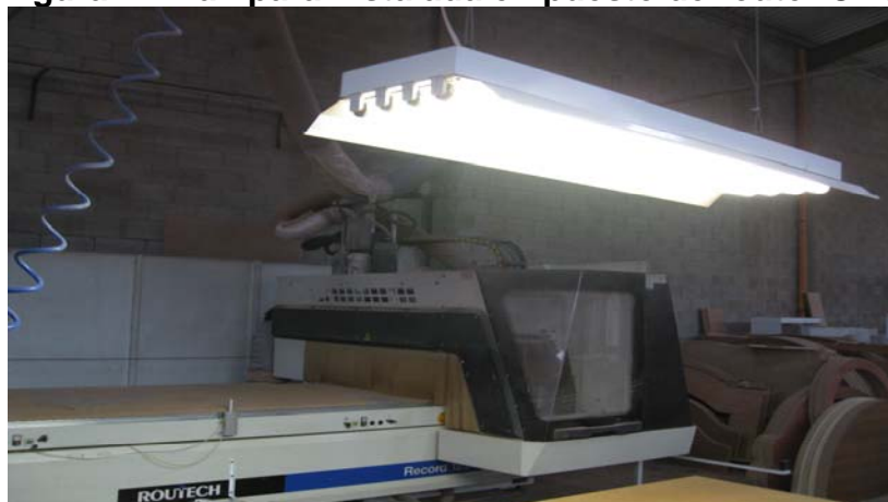
Figura 17. Lámpara instalada en puesto de router CNC
