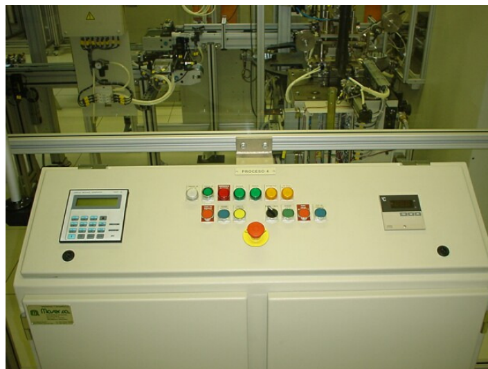
Figura 46. Panel de Control del proceso Automatizado
