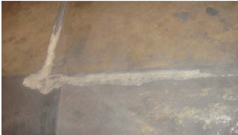
Figura 35. Daño en sisas de piso bodega producto terminado.
