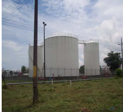
Figura 24. Tanque de almacenamiento
