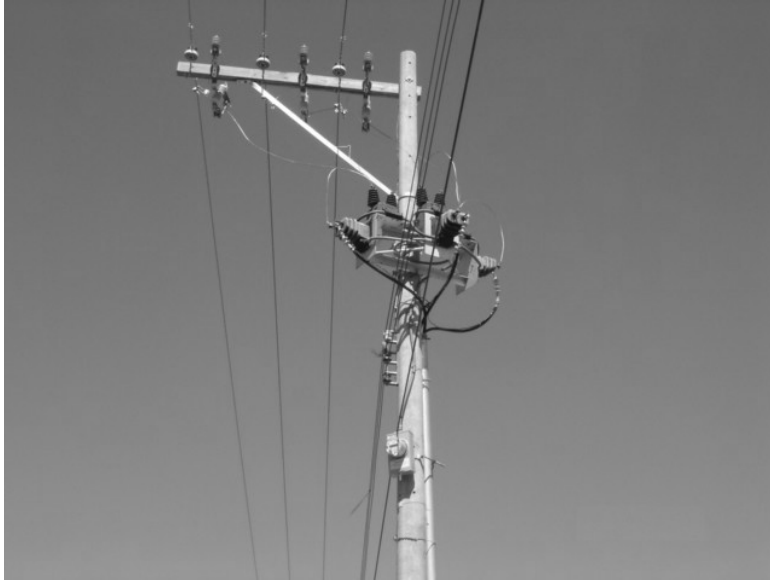
Figura 7 Fotografía de una medición primaria (nótese que no hay transformadores de la empresa distribuidora)
