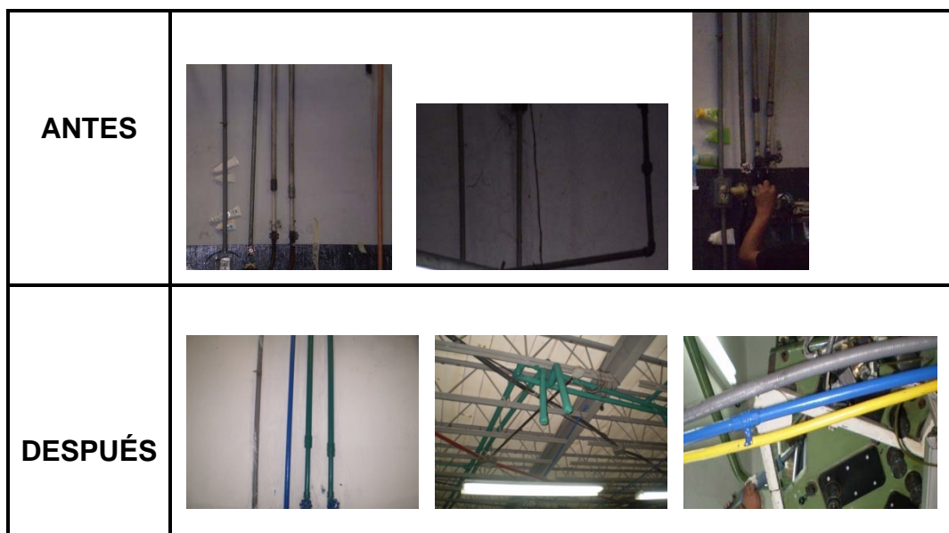
Figura 66. Identificación de tuberías
