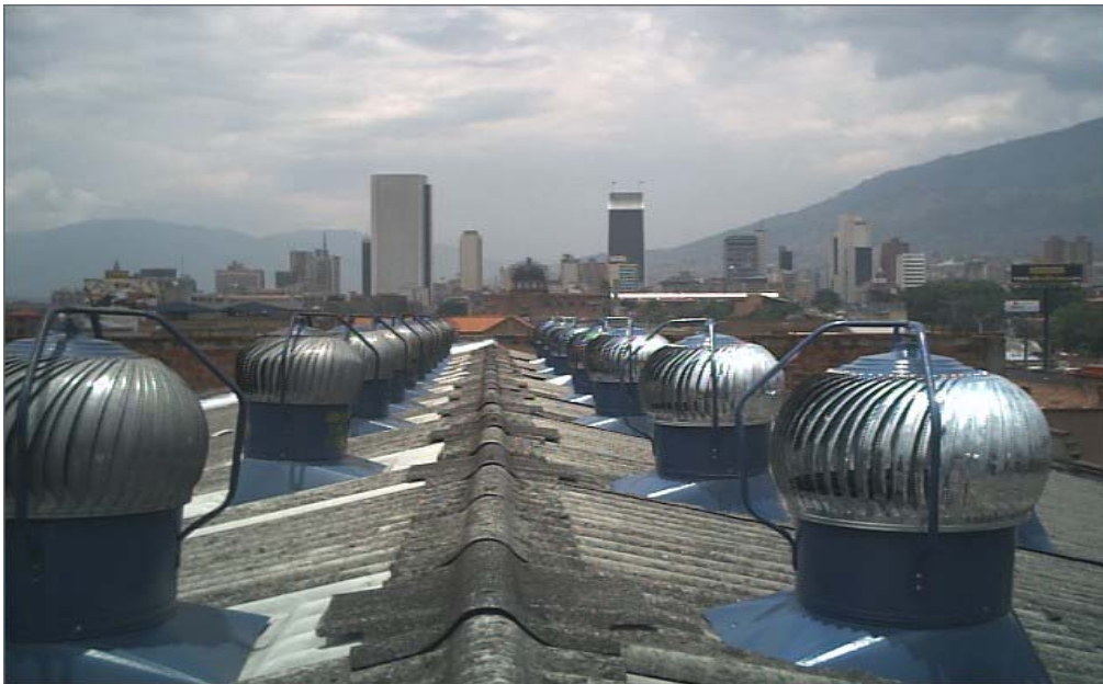
Figura 65. Instalación lateral de los extractores eólicos.
