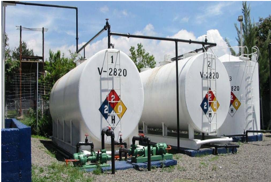
Figura 21. Tanques de almacenamiento de líquidos a granel
