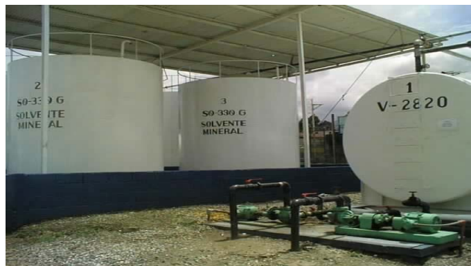
Figura 34. Tanques verticales de almacenamiento de líquidos.
