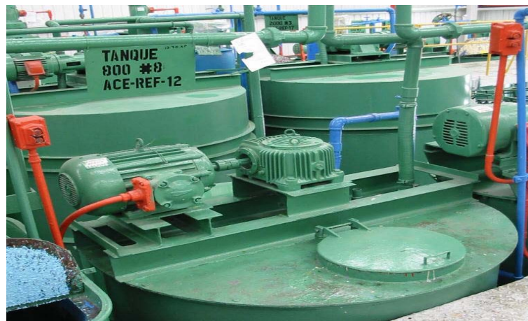
Figura 36. Tanque de refinado con motor superior
