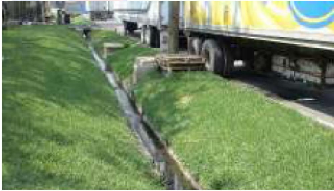
Figura 4. Drenaje de la planta.
