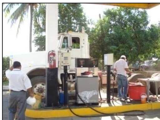
Figura 42. Bomba de despacho de combustible
