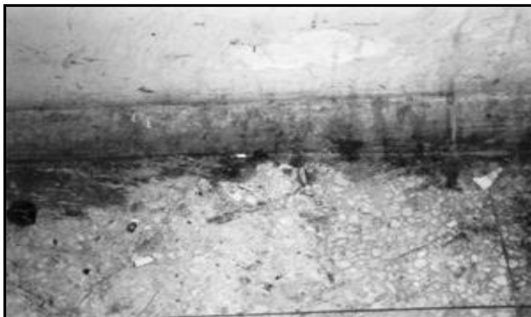
Figura 9. Fotografía de piso sucio y deteriorado.
