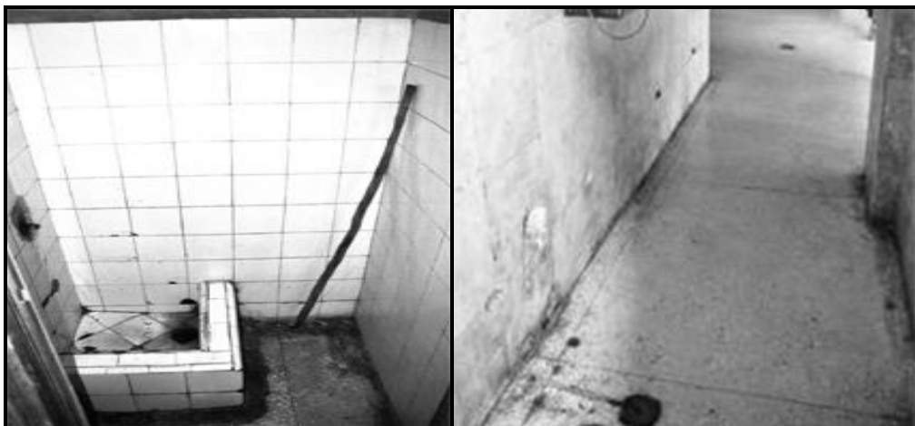
Figura 13. Fotografías de suciedad en los elementos que deben limpiarse.
