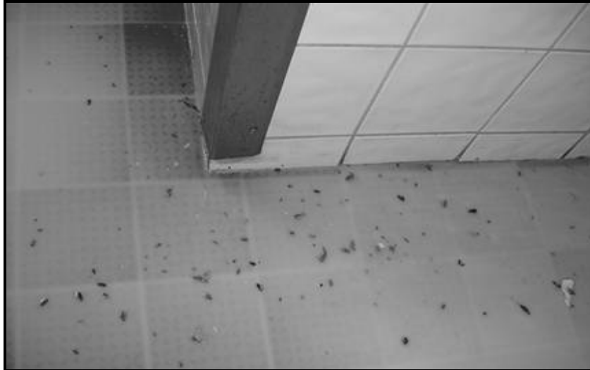
Figura 3. Fotografía de pasillos sucios.
