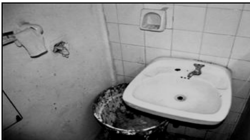
Figura 10. Fotografía de baños con suciedad incrustada.
