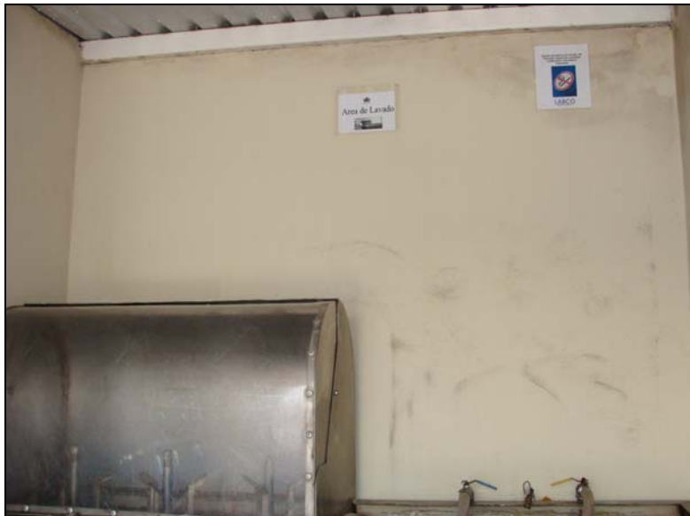
Fuente: Planta de agua purificada
