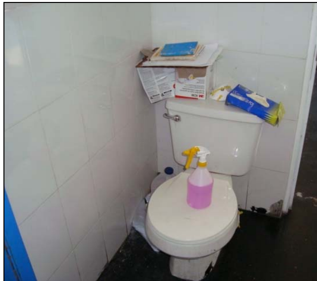
Figura 10. Servicio sanitario deshabilitado en donde se almacenan insumos de trabajo
