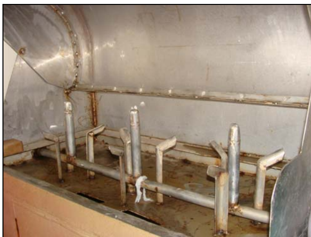
Figura 12. Lavadora de cloro vista interior
