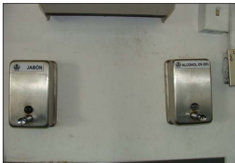
Fuente: Planta de agua purificada
