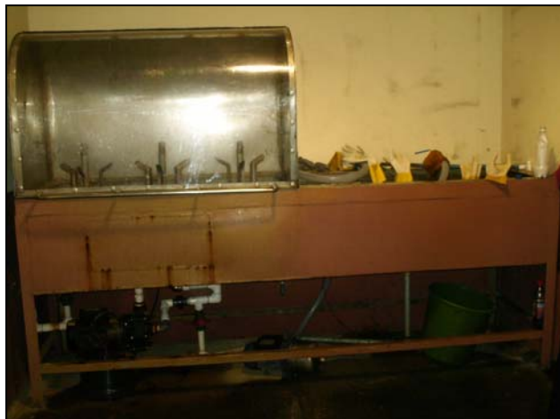
Figura 11. Lavadora de cloro vista exterior
