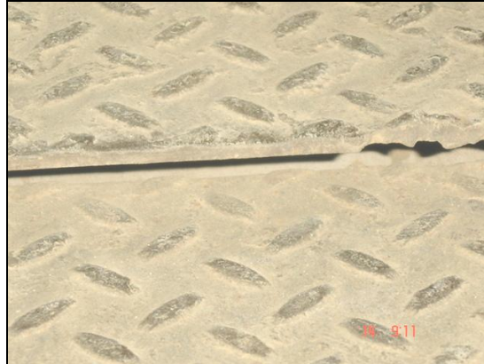
Figura 40. Hundimiento de superficie metálica en el área de carga de las líneas de producción.
