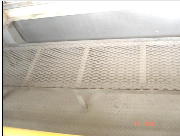
Figura 39. Implementación de tarima metálica en sustitución de la banda transportadora para la limpieza de la mezcladora.
