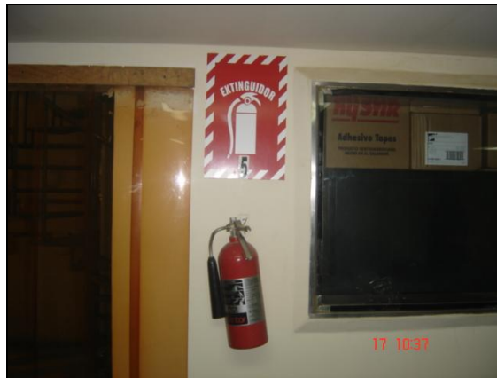
Figura 62. Ubicación de extintores para su uso dentro de las instalaciones.
