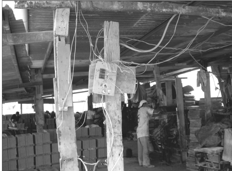
Figura No. 15. Cableado eléctrico en fábrica Véliz
