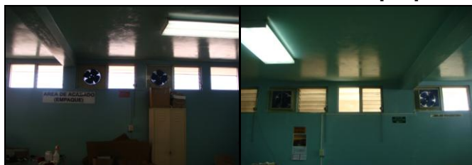
Figura 26. Sistema de ventilación en el área de empaque
