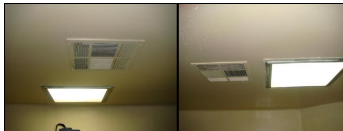
Figura 24. Sistema de ventilación
