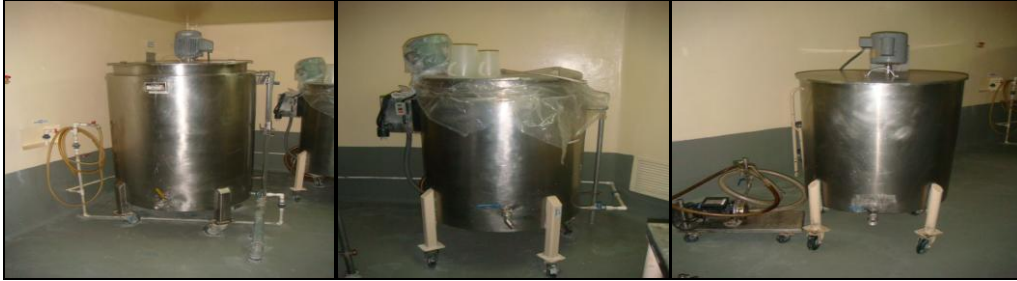
Figura 13. Tanques de acero inoxidable
