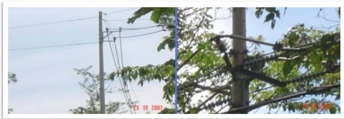
Figura 22. Instalaciones de distribución con cables y herrajes protegidos
