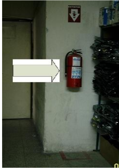
Figura 44. Extintor localizado en bodega
