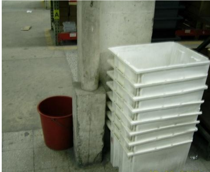
Figura 43. Instalación de aguas pluviales y servidas vulnerable
