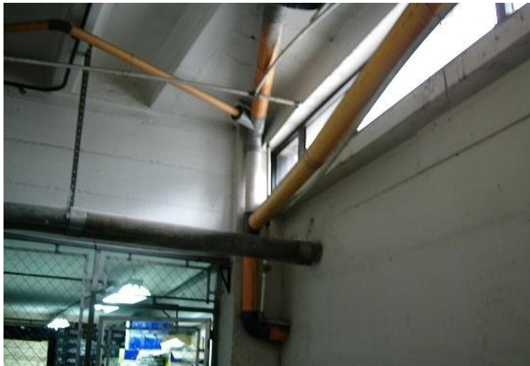
Figura 42. Tubería de agua pluvial y servida, bodega
