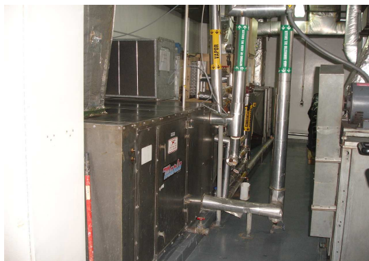
Figura 16 Fotografía de los sistemas de deshumidificación a cambiar en la planta de producción
