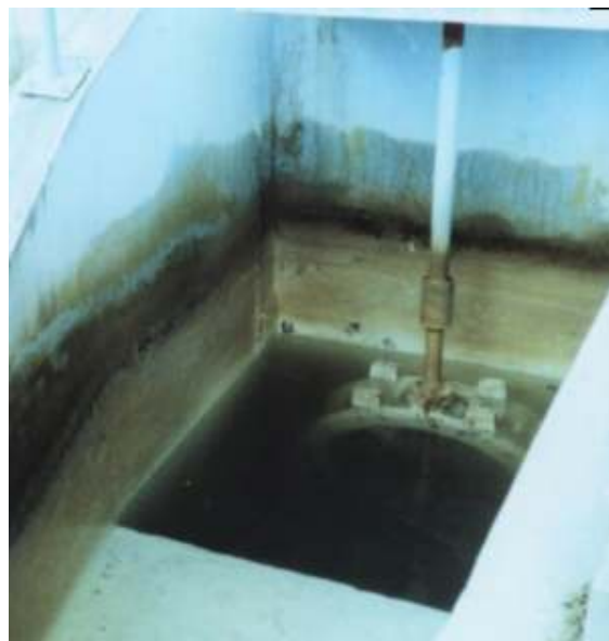
Válvula de mariposa antes del parshall secundario
