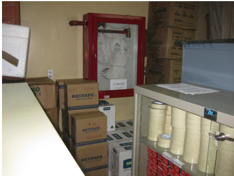
Figura 11. Ubicación de la manguera contra incendios
