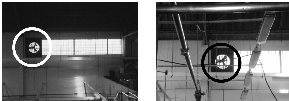
Figura 8. Ventilación nave central
