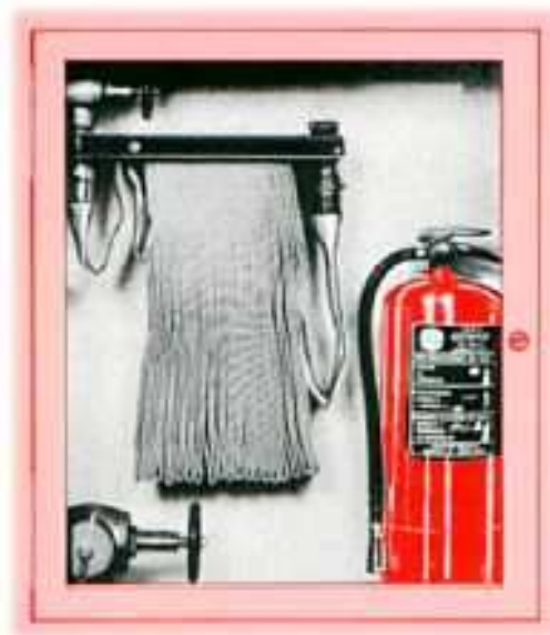
Figura 71. Empotramiento de gabinetes contra incendios en paredes
