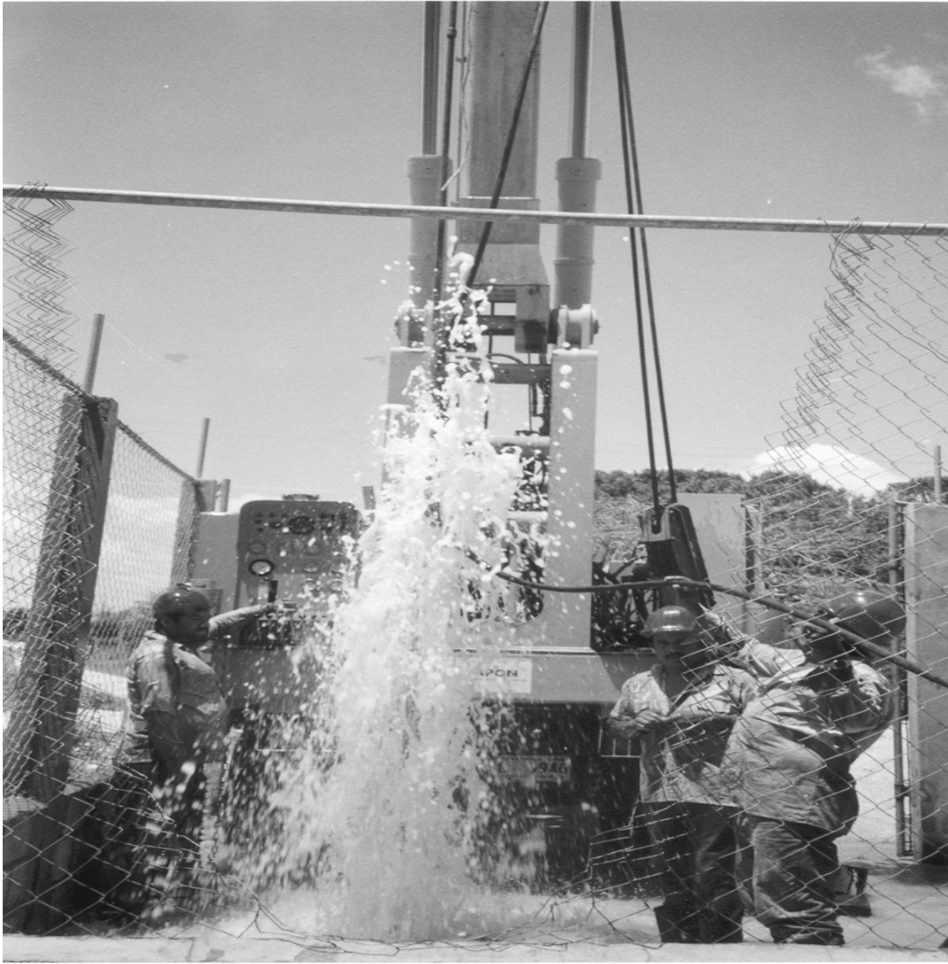
Figura 9. Limpieza del pozo por medio de aire comprimido en área de trabajo
