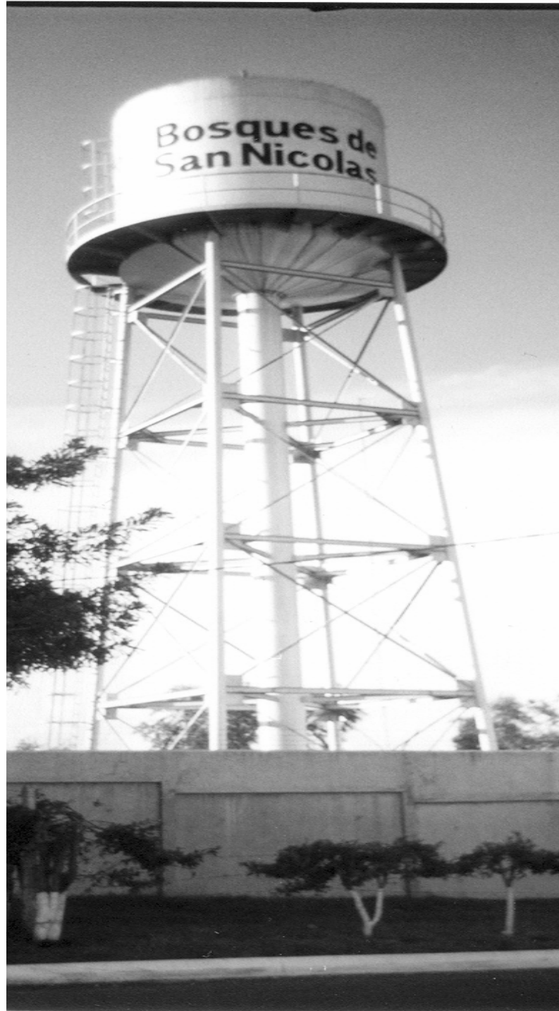
Figura 11. Tanque de distribución hacia donde se bombea el agua del pozo monitoreado
