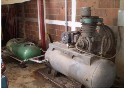
Figura 8. Compresor marca Kellogg American
