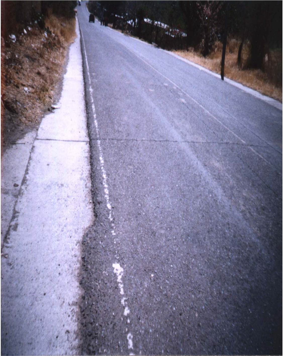
Figura 5. Sobrecarpeta de asfalto sobre pavimento de concreto con fallas a temprana edad
