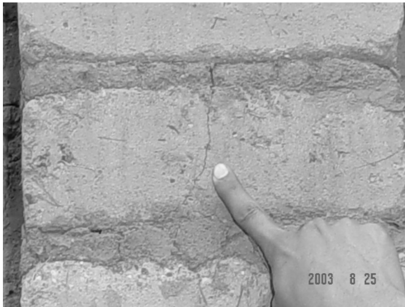
Figura 40. Falla en contrafuerte
