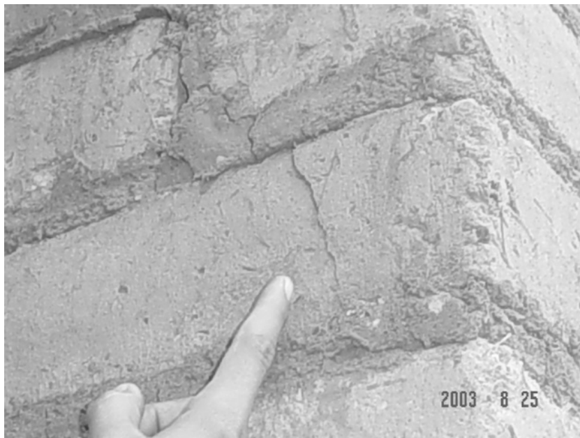
Figura 39. Falla en contrafuerte
